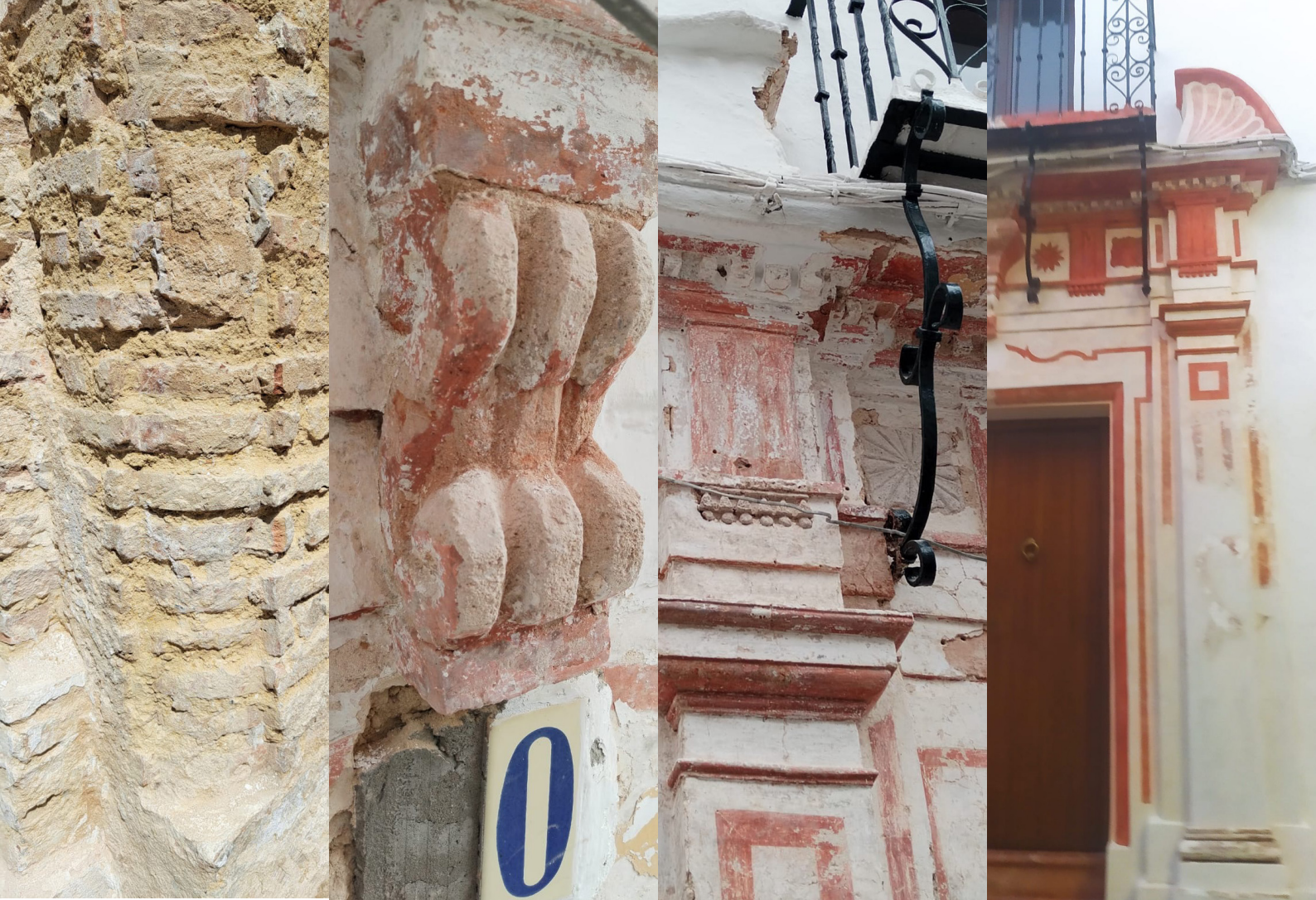
Estado de la portada antes de su restauración.
